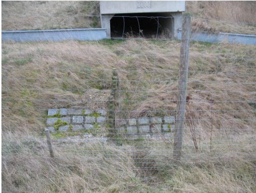
Abbildung 6: Amphibiendurchlass Nr. 4029546 - dieser Durchlass könnte auch von der Wildkatze genutzt werden. Eine aktuelle Nutzung findet derzeit wahrscheinlich durch den Dachstuhl statt. Der Zaun ist über den Durchlass zu verlegen.
